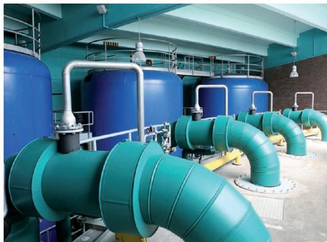
Trinkwasserfilter im Wasserwerk Am Staad.
